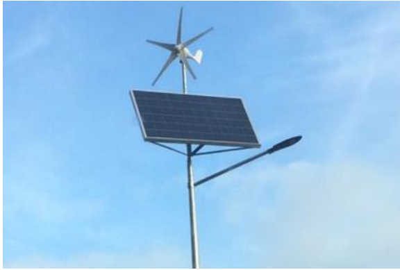
Rysunek 8. Instalacja lamp solarnych na terenie Gminy Gaworzyce – etap III – zadanie realizowane przez Gminę Gaworzyce.
