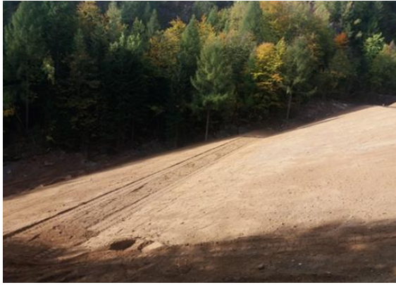
Rysunek 13. Rekultywacja składowiska odpadów komunalnych w Wojcieszowie – zadanie realizowane przez Gminę Wojcieszów
