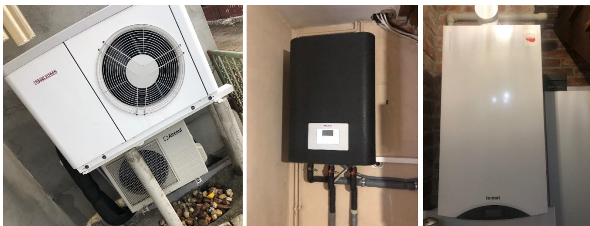
Rysunek 9. Wymiana źródeł ciepła w budynkach mieszkalnych.
