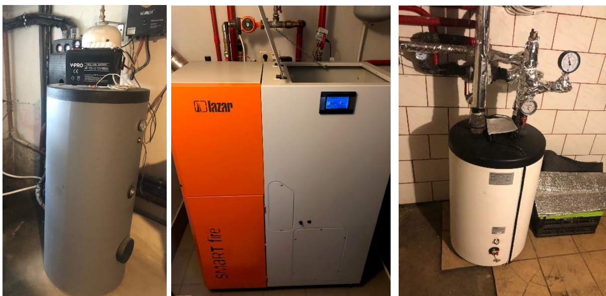
Rysunek 10. Zakup i montaż źródła ciepła wraz z instalacją ciepłej wody użytkowej.
