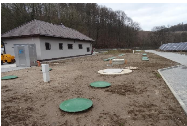
Rysunek 6. zadanie pn. „Zakończenie budowy kanalizacji ściekowej w Wojcieszowie poprzez budowę oczyszczalni ścieków oraz kanalizacji sanitarnej – etap VB” realizowane przez Gminę Wojcieszów.
